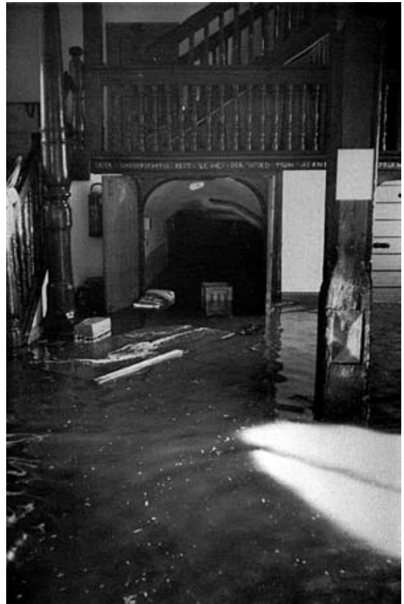
Im Herborner Rathaus hatte das Hochwasser das Kellergeschoss mit dem Archivräum vollständig, die Eingangshalle halbhoch überschwemmt (aus: Heimatjahrbuch für das Land an der Dill 1985, S. 140). Zum nebenstehenden Beitrag. ▶
