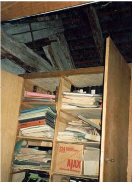
„Unterbringung“ eines Pfarrarchivs auf einem Dachboden (alter Zustand 1999).
