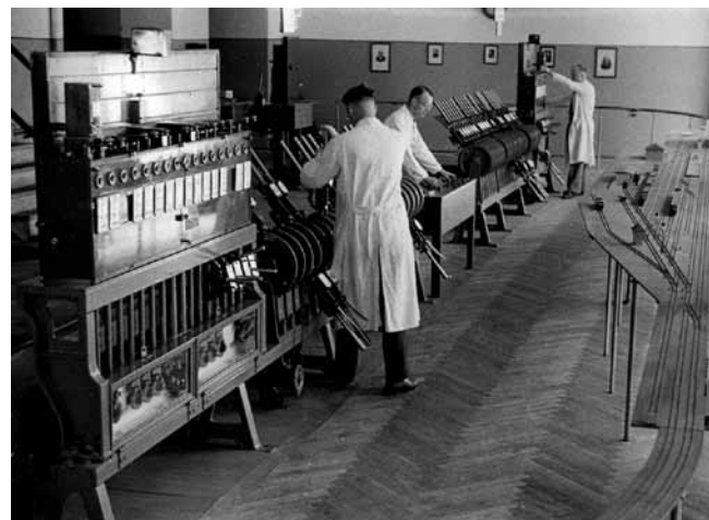
Durchgangsbahnhof mit Stellwerk und Schalttisch
